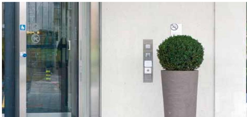
Contrôle des accès à l'entrée principale de la clinique Hirslanden à Zurich, grâce à un lecteur mural en ligne XS4 2.0 de Salto.
